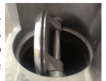
Válvula aberta totalmente
